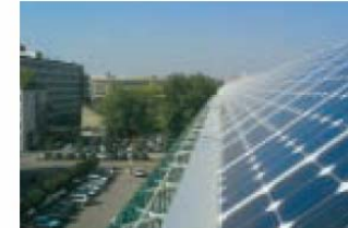
Exemple de surimposition en toiture terrasse (Apex bp solar)
